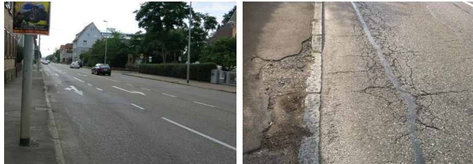
Abbildung 18: Fahrbahnoberfläche in der Stuttgarter Straße (links) und der Ulmer Straße (rechts)
