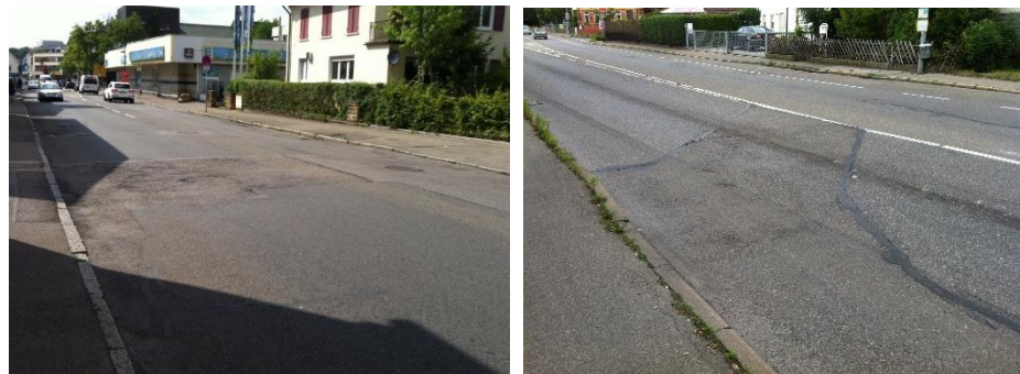
Abbildung 19: Fahrbahnoberfläche in der Salacher Straße (links) und der Hindenburgstraße (rechts)
