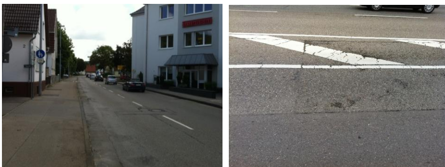
Abbildung 22: Fahrbahnoberfläche in der Donzdorfer Straße (links) und der Hauptstraße (rechts)
