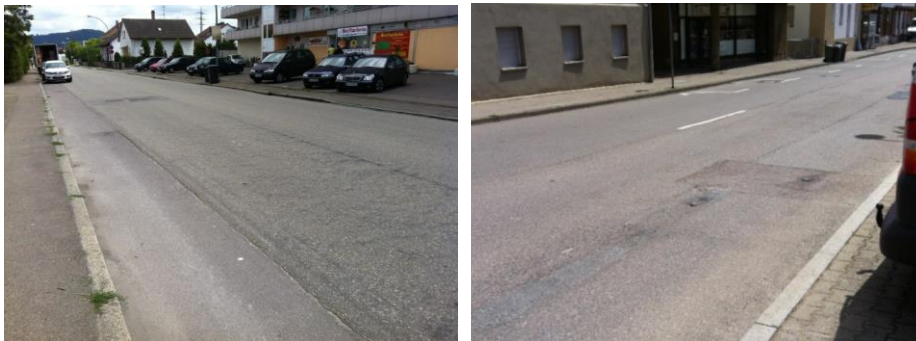
Abbildung 21: Fahrbahnoberfläche in der Hauffstraße (links) und der Hauptstraße (rechts)
