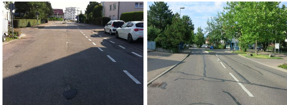
Abbildung 20: Fahrbahnoberfläche in der Holzheimer Straße (links) und der Scheerstraße (rechts)
