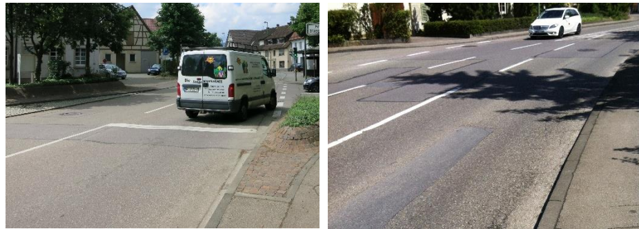
Abbildung 23: Fahrbahnoberfläche in der Heidenheimer Straße
